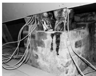
... Lüftungskanäle im stillgelegten Schornstein
