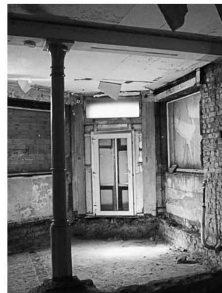
Im Erdgeschoss sind Wände und Fundament freigelegt. Der neue Fußboden wird etwas erhöht
