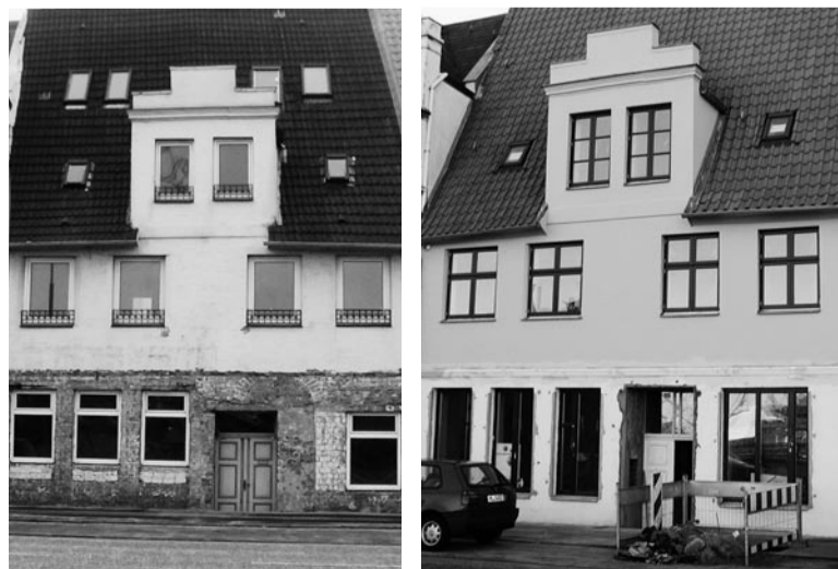
Nach der fast fertigen Sanierung zieren wieder mehrteilige Fenster die Fassade. Die Anzahl der Dachflächenfenster wurde deutlich reduziert
