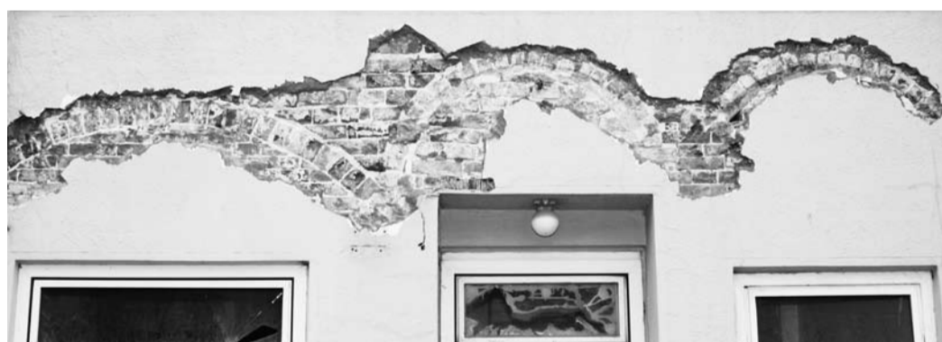
Straßenfassade: Der breitere Sturz links zeigt, dass hier früher eine Tordurchfahrt war
