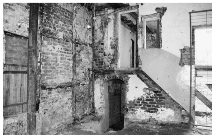
Ohne Aufgang: In der Nr. 106 war zuletzt kein Treppenhaus mehr
