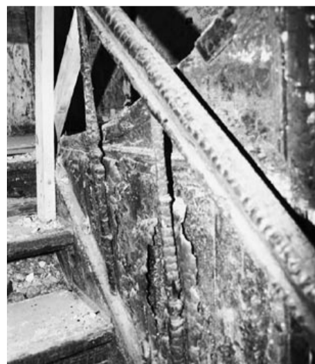
Sanierungsbedarf: verkohltes Treppengeländer
