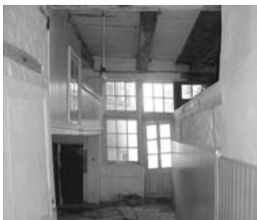
Die Diele im Erdgeschoss der Glockengießerstraße 75 ist sanierungsbedürftig
