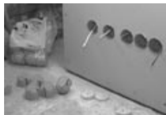
Moderne Verkabelung: TV, Telefon und Strom
