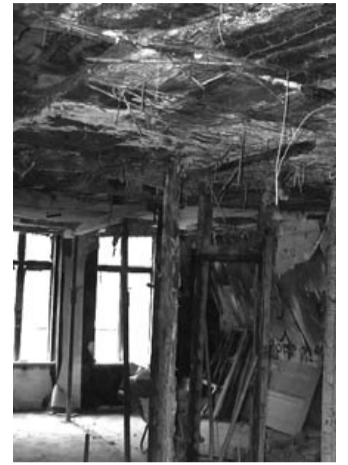
Zwei Brände hatten das Haus unbewohnbar gemacht
