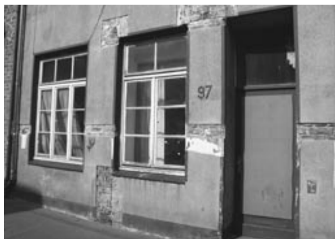
Die Fassade der Glockengießerstraße 97: Der an einigen Stellen entfernte Putz offenbart die Baugeschichte des Gebäudes. Die Eingangstür lag ursprünglich in der Mitte des Hauses
