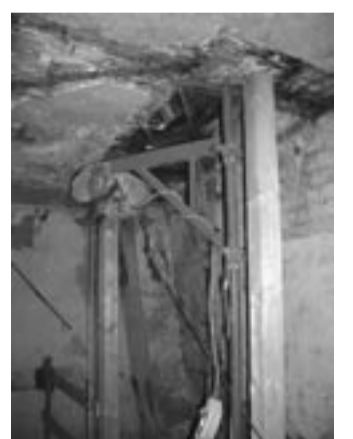
Vorsicht Einsturzgefahr: Teile des Hauses werden durch Stützen gesichert
