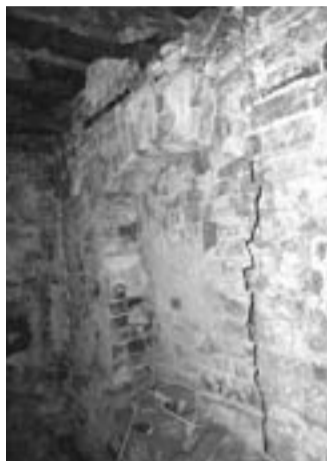
Vor der Sanierung: Risse ziehen sich durch die Brandmauer
