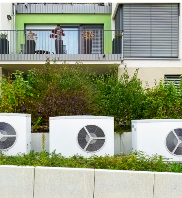
Auch Mehrfamilienhäuser können durch hintereinandergeschaltete Luftwärmepumpen versorgt werden.
